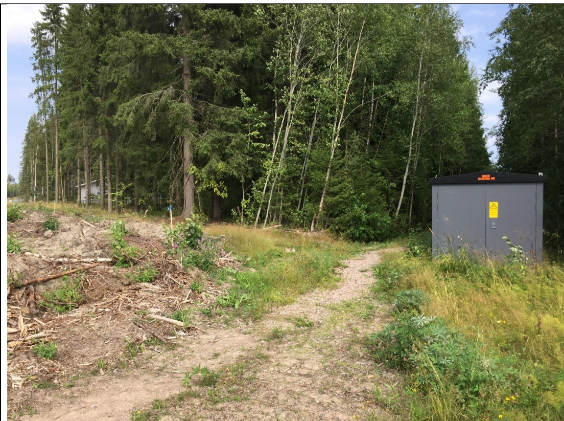
Puistomuuntamo on rakennettu vuonna 2014 kaava-alueen eteläosaan.
