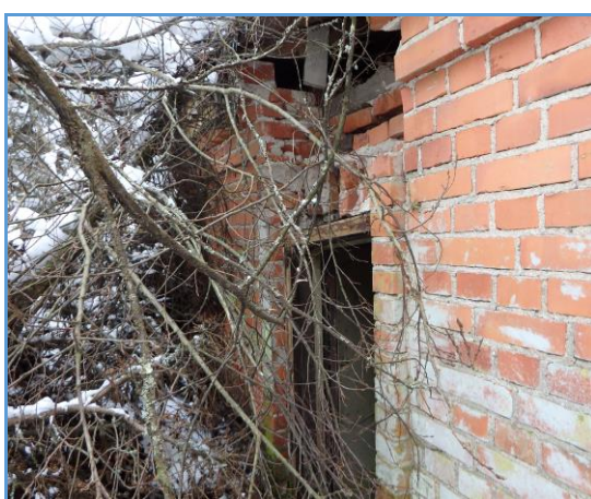
Kuva 9. Tiilirakennus on paikoin sortunut.
