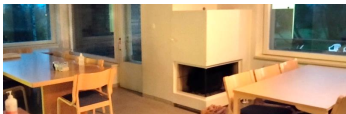
Kuva 4: Käytöstä poistettu avotakka 2021.
